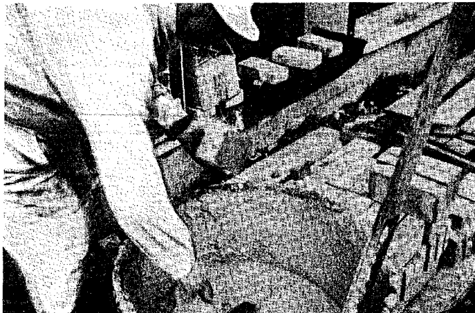
Fig. 14. Opmuring med fyldte fuger.
